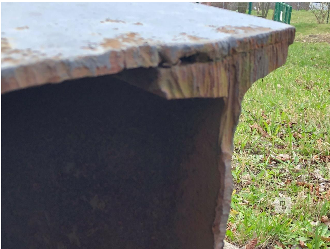
Fot. 14. Fragment słupa kratownicy stan zachowania
