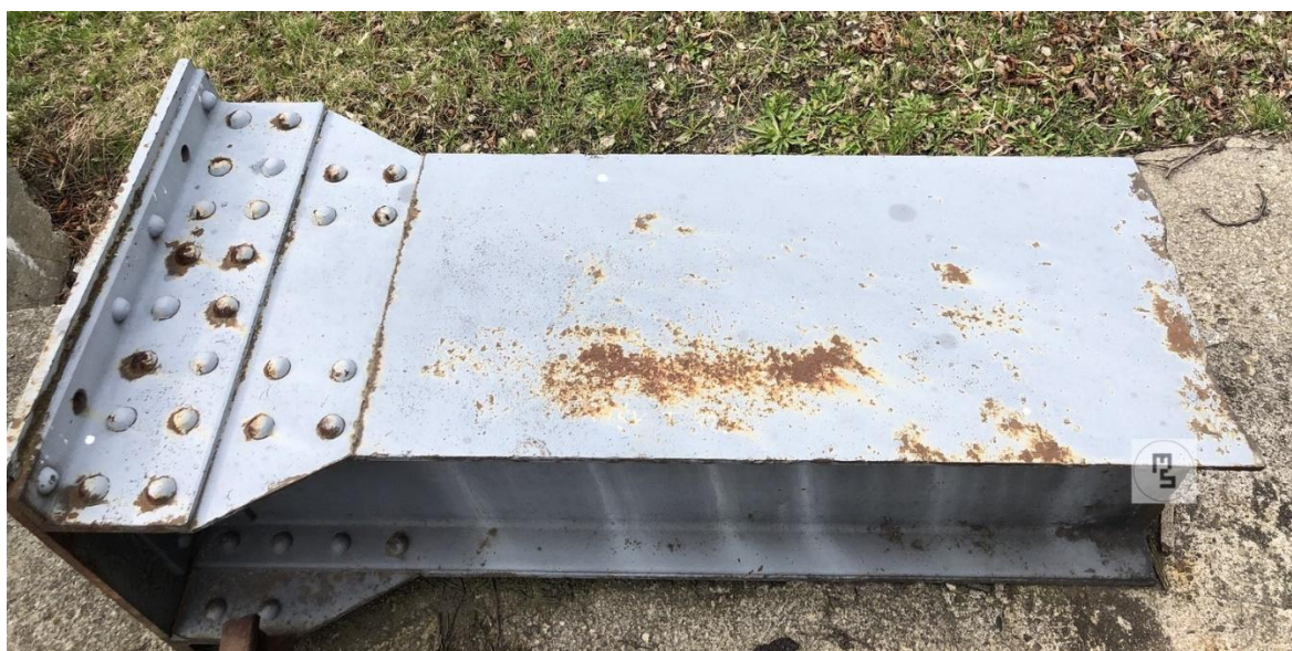
Fot. 11. Fragment słupa kratownicy stan zachowania
