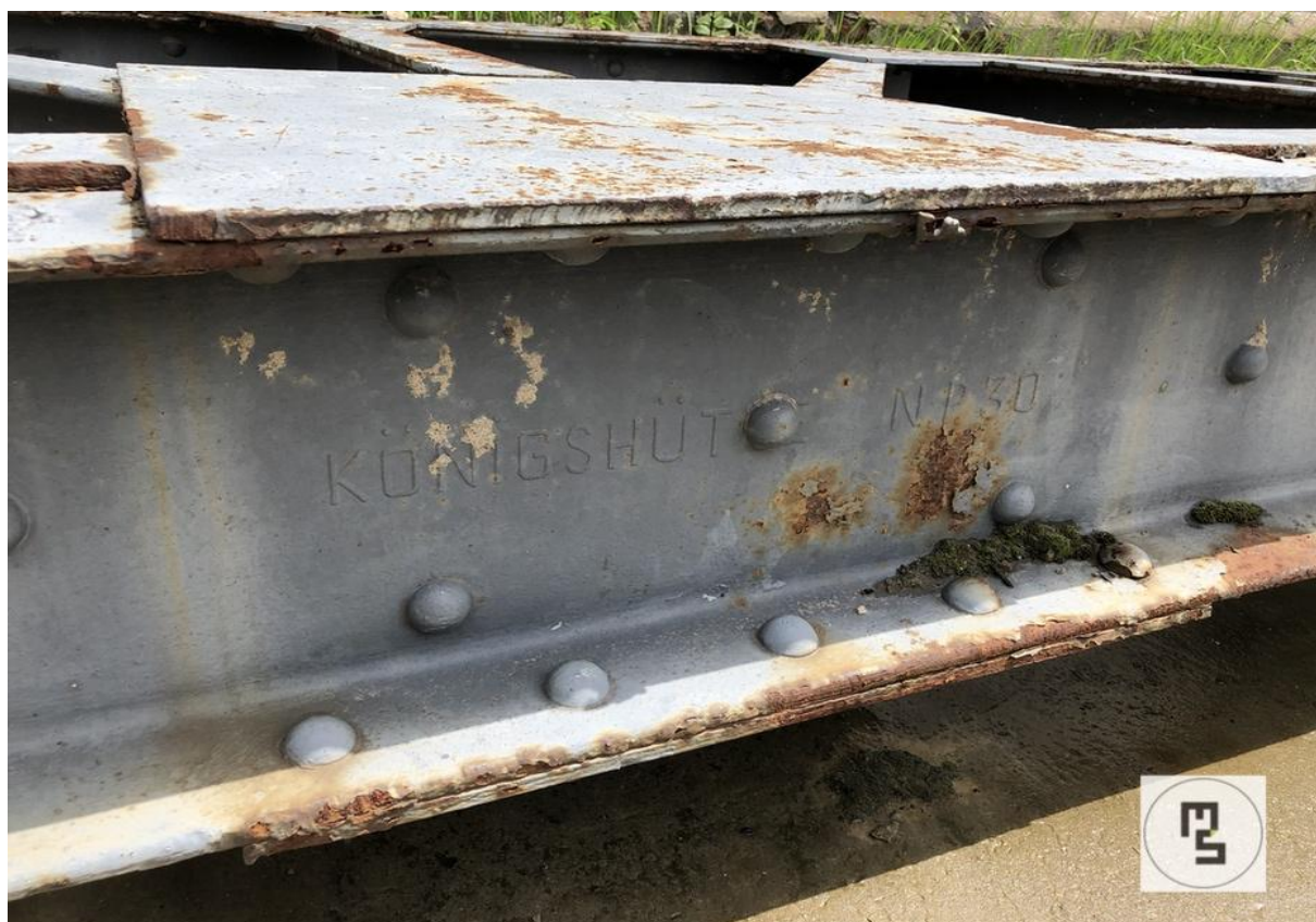
Fot. 9. Stan zachowania
