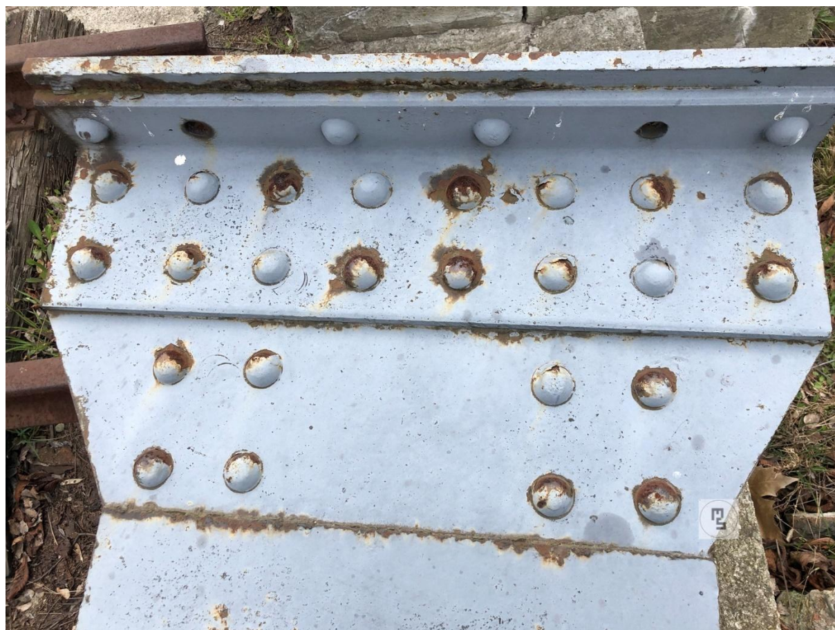
Fot. 13. Fragment słupa kratownicy, stan zachowania
