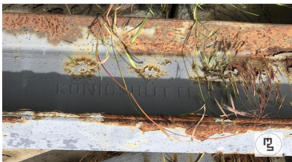
Fot. 6. Stan zachowania
