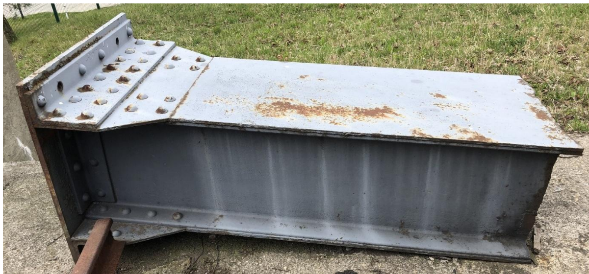
Fot. 12. Fragment słupa kratownicy stan zachowania
