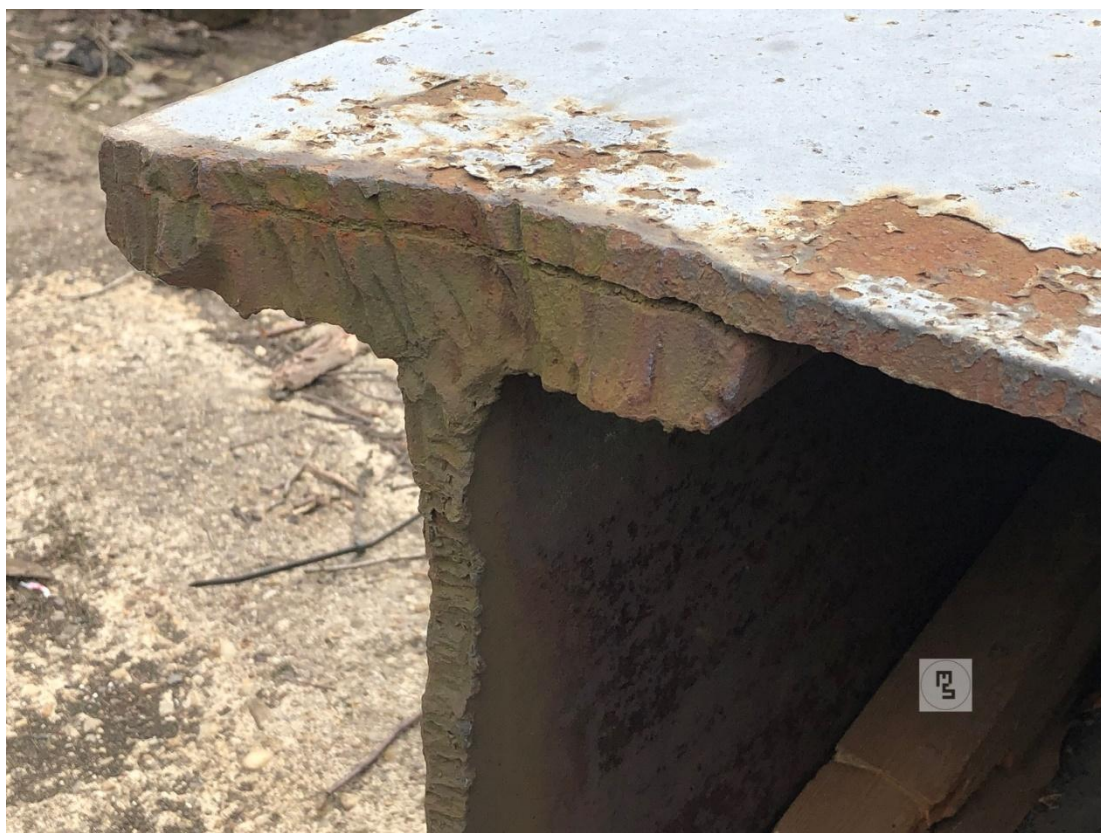
Fot. 15. Fragment słupa kratownicy stan zachowania
