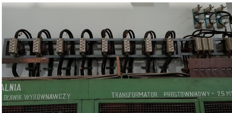
Fot. 2. Obecny stan styczników średniego napięcia.
