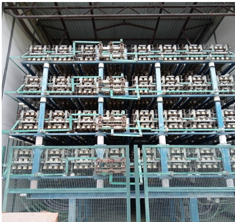
Fot. 10. Widok na frontową część opornicy wielkiej mocy.
