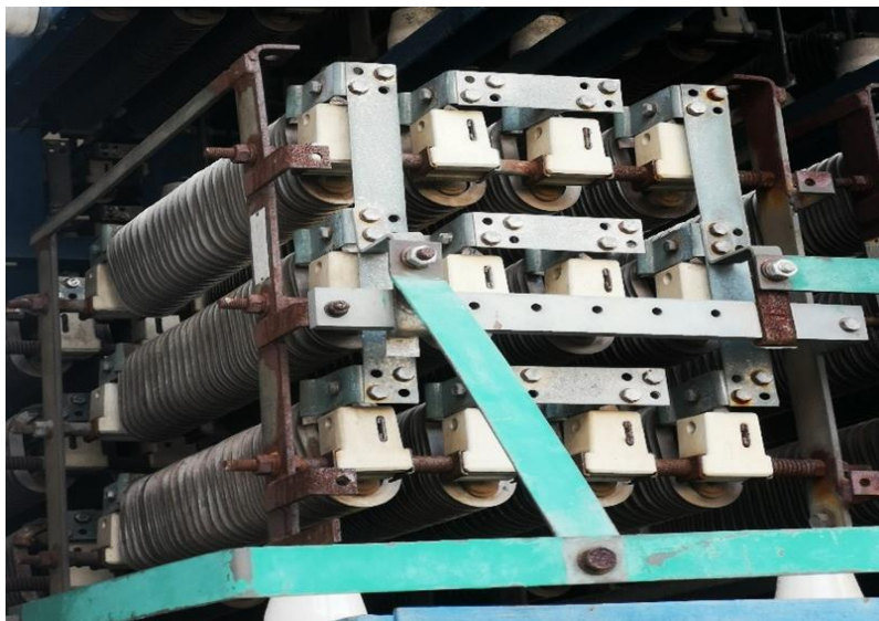
Fot. 9. Moduł rezystancyjny opornicy wielkiej mocy.
