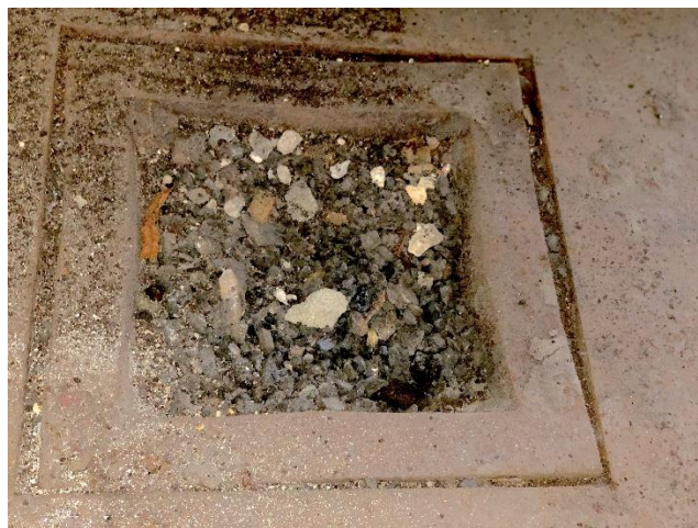
Fot. 5 Stan zachowania- wgłębienie
