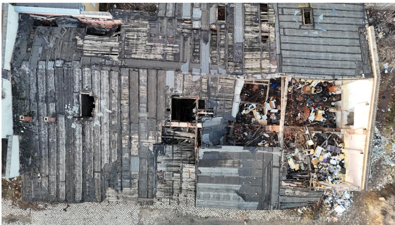
Fot. 5: Zawalony dach budynku byłego magazynu kolejowego na dz. nr 201/85
