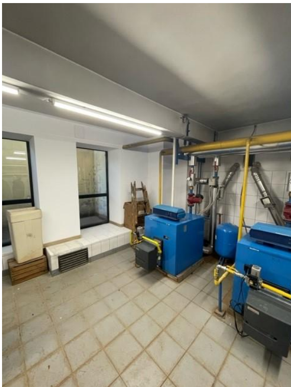
Widok na istniejącą kotłownię gazową
