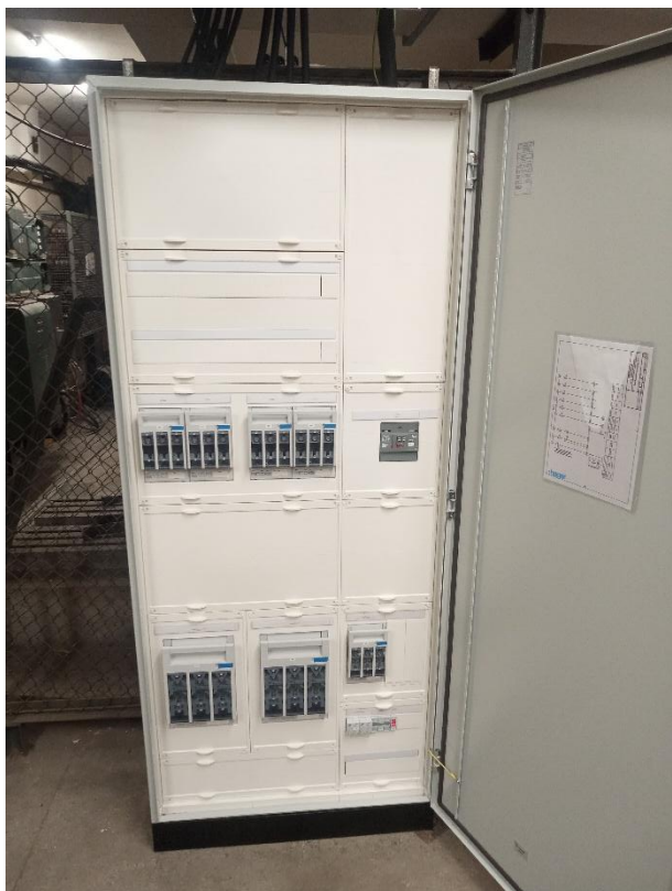
Rozdzielnia główna PP-2 zlokalizowana w piwnicy budynku 20
