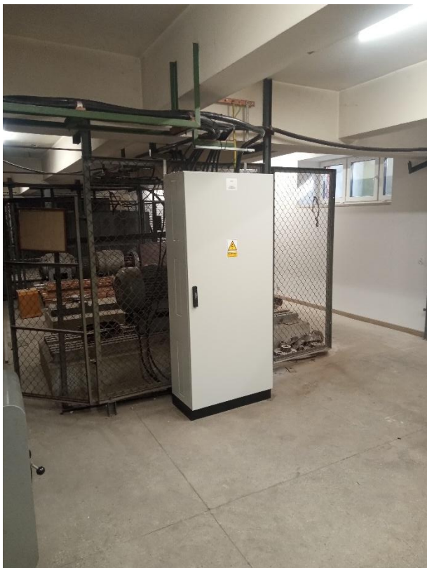
Rozdzielnia główna PP-2 zlokalizowana w piwnicy budynku 20
