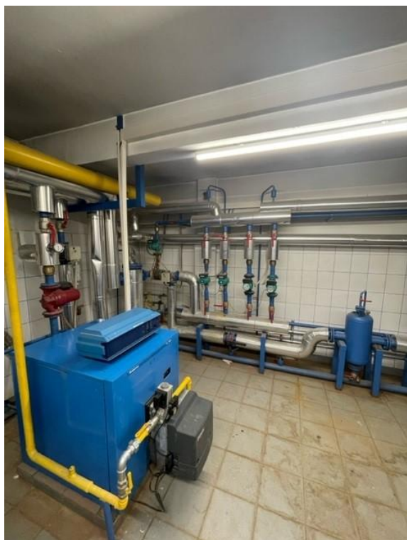
Widok na istniejącą kotłownię gazową
