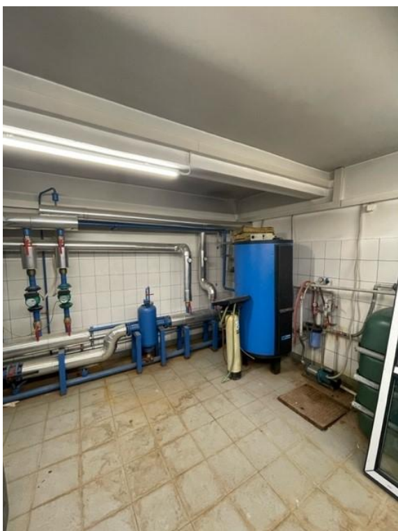
Widok na istniejącą kotłownię gazową
