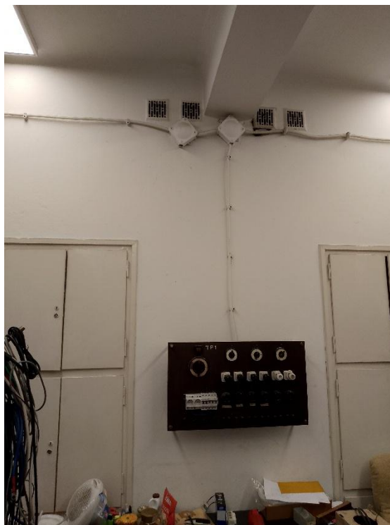
Fot. 17 – przykładowe zdjęcie pomieszczenia z kratkami wentylacyjnymi
