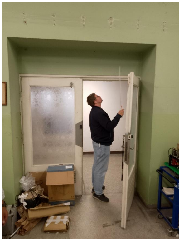
Fot. 2. Istniejące drzwi do pomieszczenia 11 (od wewnątrz)
