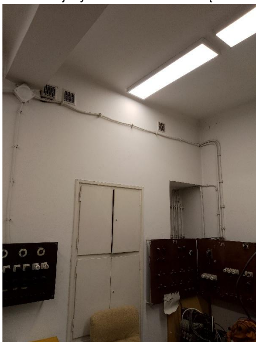
Fot. 11 Tablice wraz z okablowaniem do usunięcia
