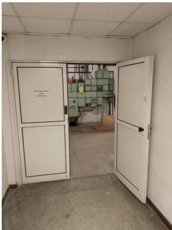
Fot. 4. Drzwi pomiędzy łącznikiem między budynkami 7 i 20
