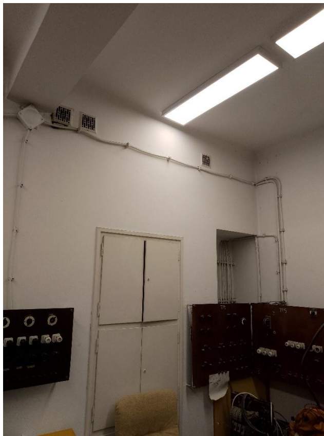
Fot. 18 – przykładowe zdjęcie pomieszczenia z kratkami wentylacyjnymi
