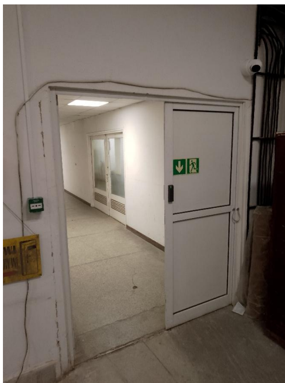
Fot. 3. Drzwi pomiędzy łącznikiem między budynkami 7 i 20
