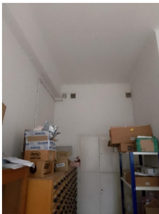
Fot. 19 – przykładowe zdjęcie pomieszczenia z kratkami wentylacyjnymi
