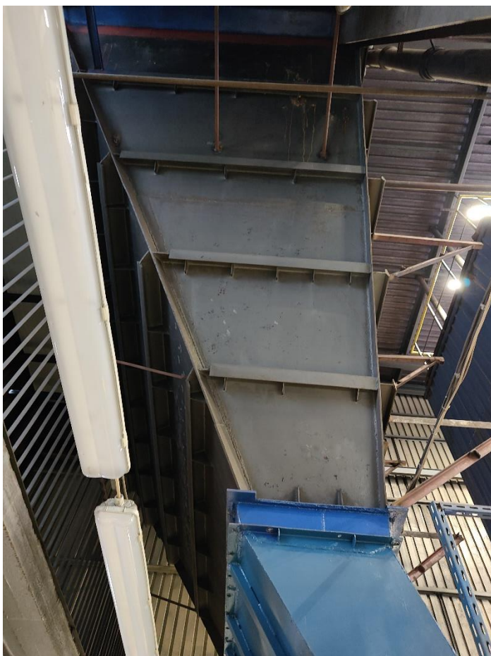
Zdjęcie 2. Widok zasobnika kotła nr 6
