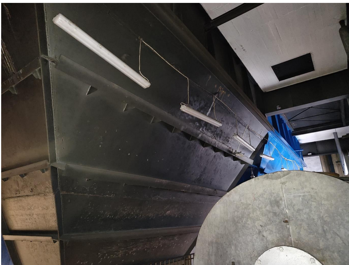
Zdjęcie 4. Widok zasobnika kotła nr 6
