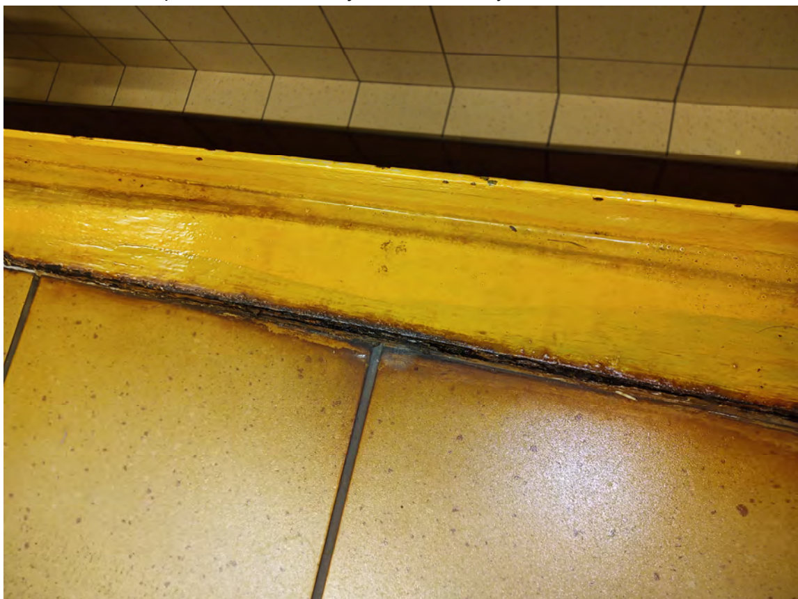
Fot.16 – Uszkodzenia posadzki - deformacja w strefie na styku z torem.
