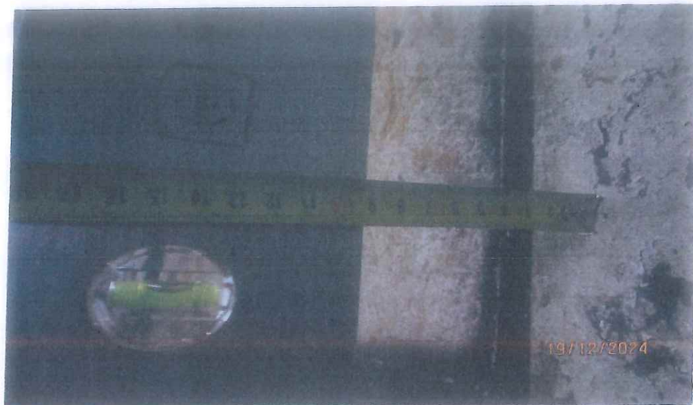
Znaczne wypaczenie drzwi, odchylenie od pionu do 9cm
