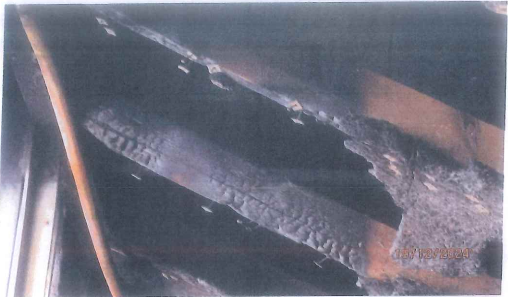
Częściowe zwęglenie belek, konstrukcja sufitu podwieszanego
